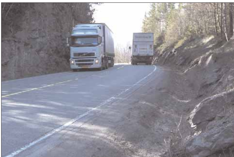
Mellom Ulsberg og Berkåk og Ulsberg og Nåverdalen skal det i sommer sprenges bort berghammere for å skape en tryggere vei.
