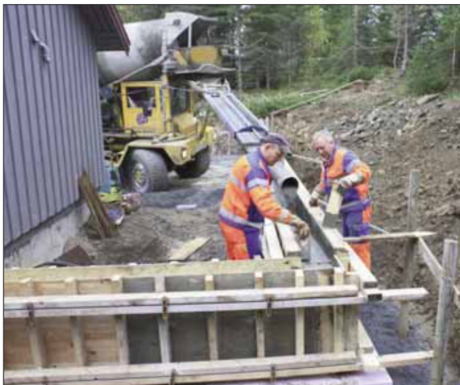
Han Joar Skamfer og Odd Myren i gang med støping til det nye renseanlegget.
